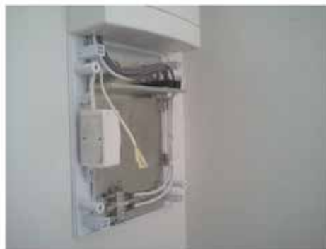
Kotijakamoon tulevaan valokaapeliin on jätetty liian pieni työvara.
