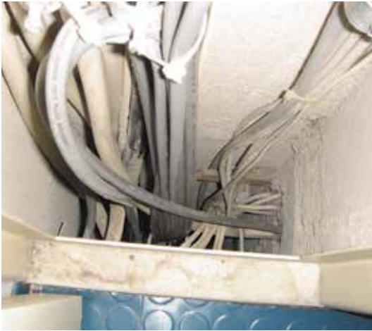
Kuva 4.13. Hybridikaapeleita asuinkiinteistön nousukuilussa (saneerauskohde).
