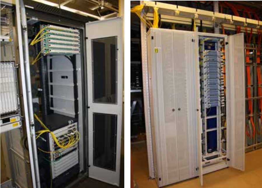
Kuva 2.29. Esimerkkejä jakamotelineistä. a) perinteinen 19 tuuman mekaniikka, b) erityisesti optista kaapelointia varten suunniteltu ja kehitetty mekaniikka (Kuvat Nestor Cables Oy).
