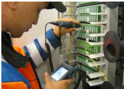
Kuva 5.17. Päätepaneelin liittimien tarkastusta videomikroskoopilla (Kuva Eltel Networks Oy).
